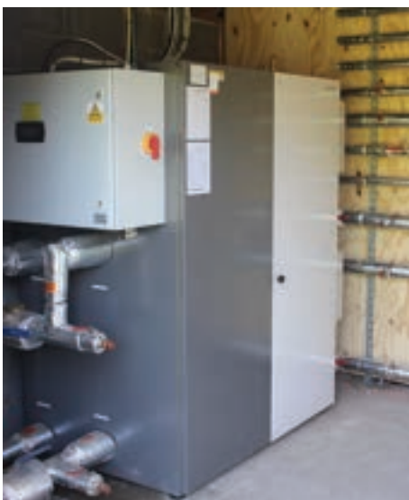
Above: A Lämpöässä heat pump
